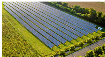
Freiflächenphotovoltaikanlagen Foto: Stadt Öhringen
