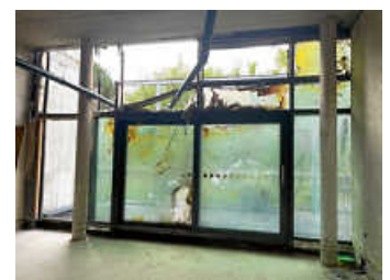
Feuerschäden in der Sauna an der Fensterfront
