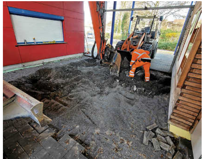
Das Öhringer Freibad „H 2 O – das Strandbad“ öffnet am 20. April. Dann startet auch der Vorverkauf der Saisonkarten. Sie werden digitalisiert und können am neuen Kassenautomaten schnell abgescannt werden. Die Umbauarbeiten für den neuen Automaten sind bereits angelaufen Foto: Stadt Öhringen
