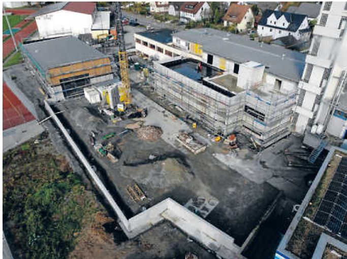
Das gesamte Baustellengelände der Feuerwehr aus der Luft mit Altbau, Anbau und neuer Fahrzeughalle Foto: Stadt Öhringen
