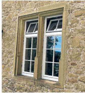
Im Rathaus werden Zug um Zug neue und dichte Fenster eingebaut Foto: Stadt Öhringen
