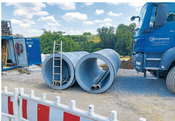
Die Rohre zur Ableitung des Wassers haben 1,2 Meter im Durchmesser Foto: Stadt Öhringen
