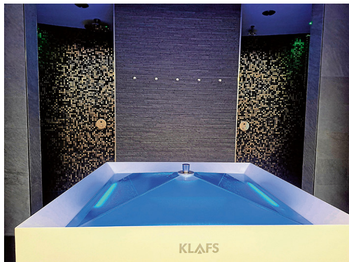
Modernes Lichtdesign und Optik in Eisbecken und Dusche
