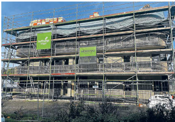
Das erste Hoffnungshaus an der Kuhallmand gegenüber vom Öhringer Friedhof ist bereits aufgestellt
